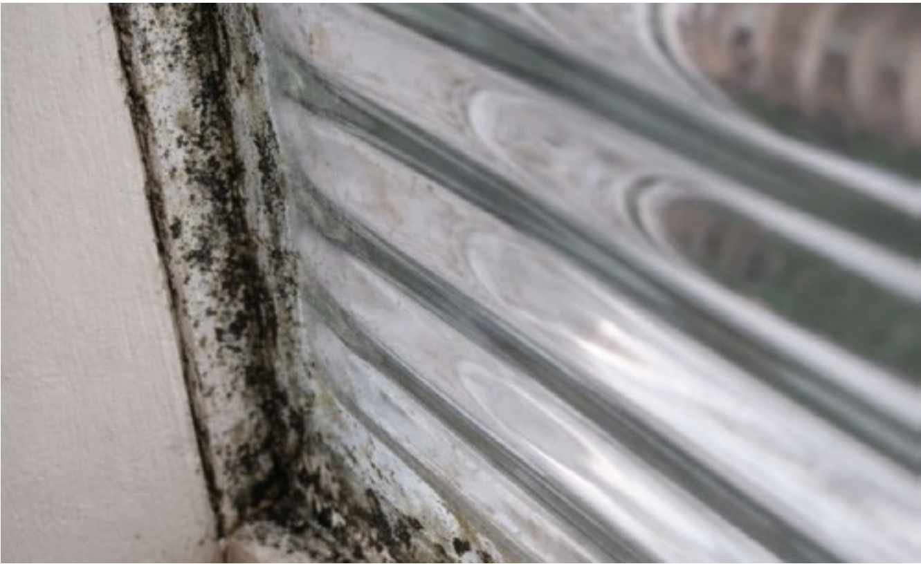
Dikke laag schimmel bij het raam in de woning van Georgette.
